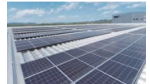
太陽光パネル：タツタテクニカルセンター
