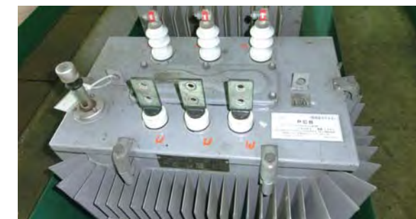
写真は、微量PCB汚染廃電機器の保管状況です。
