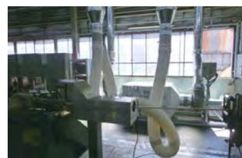
写真は、VOCの回収のための活性炭吸着装置です。
