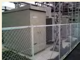
▲<改造事例> 受電設備
