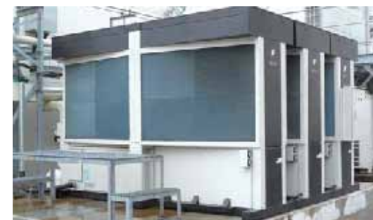
◇上は、京都工場で老朽化に伴い更新・導入した省エネ型エアコンの室外機です。その省エネ効果は、電力量で約96kWの削減、原油換算で約24klの削減となり、新たに設置した製品保管用冷蔵庫の使用電力の多くを賄うことができました。
