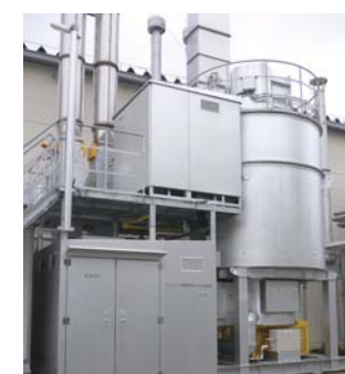
◇左は、京都工場を導入した、蓄熱燃焼式の排ガス処理装置です。 乾燥式の脱臭装置と比較し、ガス消費量を導入前の約20%に抑えられ、導入後7ヵ月で約110kl(原油換算)削減することができました。
