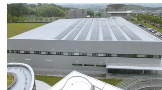
◇タツタテクニカルセンター工場棟に設置した太陽光発電モジュール
