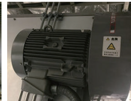
空調用の省エネモーター更新
