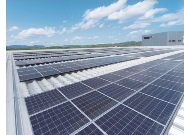
タツタテクニカルセンターの工場棟に設置した太陽光発電モジュール
