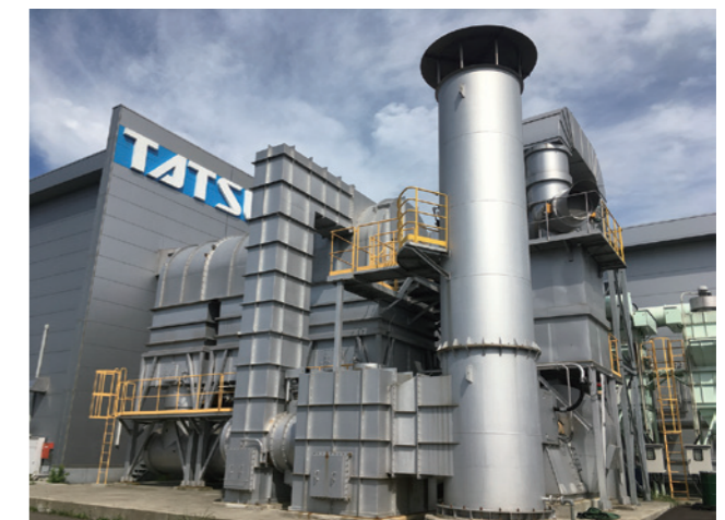
仙台工場 脱臭装置
